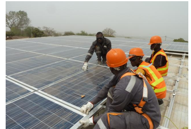
(Mini-red solar fotovoltaica en la región de Zanzan, en Costa de Marfil © Azimuth 360)
